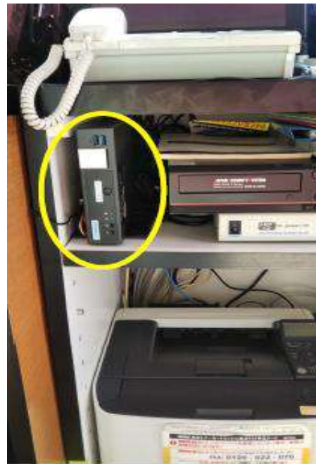
データ収集ユニット設置後 * 日付を入れて撮影してください。
